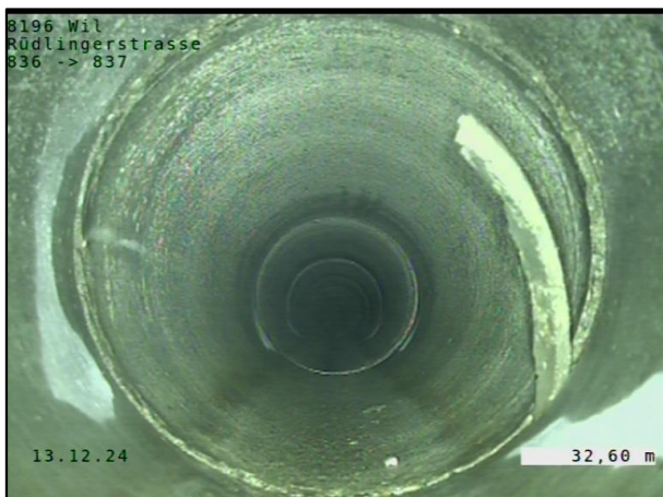
32.60 m Gegenstand ist in der Rohrverbindung eingeklemmt 4 Uhr Foto 5
