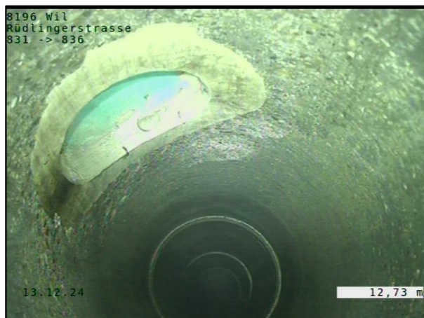
12.39 m Anschluss 10 Uhr, saniert Foto 2
